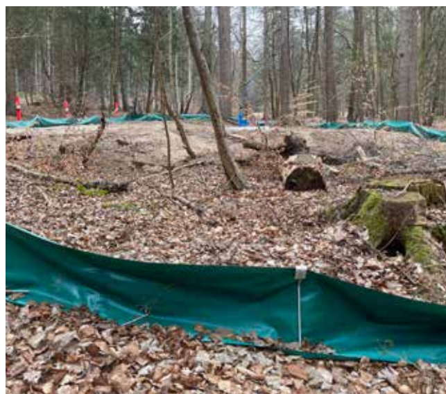
Gravearbejdet foregik bag padde-hegn, så dyr og padder ikke faldt i udgravningerne
